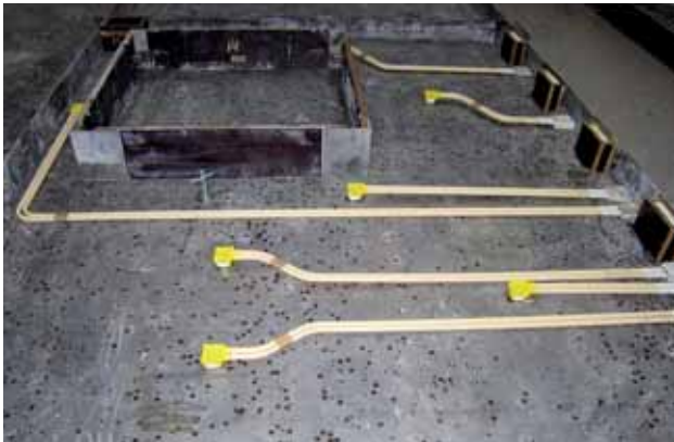
Figur 23. El-indstøbninger lagt op i støbeformen til betonelement. Bemærk at rørføringen er tilpasset de udspæringer, som ligger i bunden af elementet (billedets højre side). Rørføring skal generelt forløbe lodret i elementet. I dette element har vandret rørføring til lampeudtaget over vinduet imidlertid været eneste mulige løsning. Elementet dobbeltarmeres og el-rørene fastbindes til armeringsnettet.
