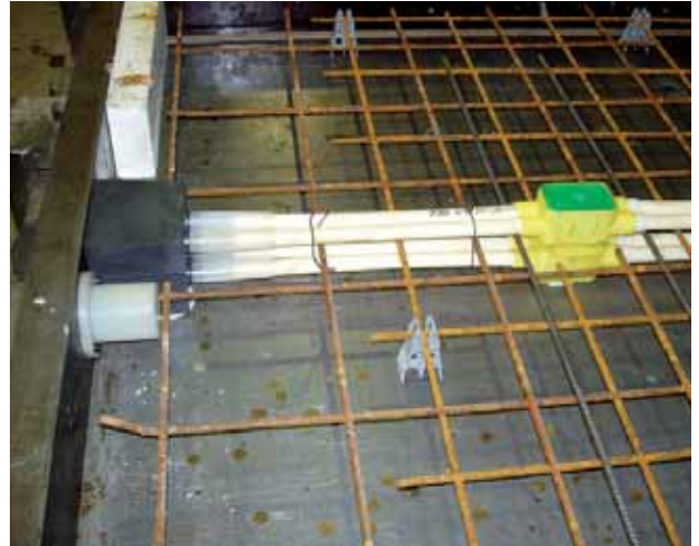
Figur 28. Fastholdelse af el-indstøbninger i opsidens af et 100 mm enkeltarmeret betonelement. Ved de to dåser, som ligger »ryg mod ryg«, har det været nødvendigt at overklippe et par armeringsstænger. Som kompensation er der ilagt supplerende armering. Rørene er fastholdt til armeringen med ståltråd.
