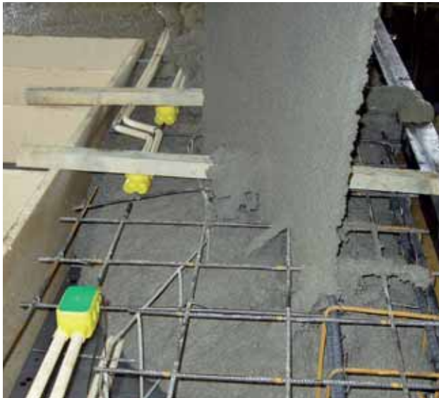
Figur 30. Udstøbning af beton. Her er flere dåser i opsidens fastholdt v.h.a. lægter. Når elementoverfladen senere skal viderebehandles, f. eks. gliettes, skal lægterne fjernes.
